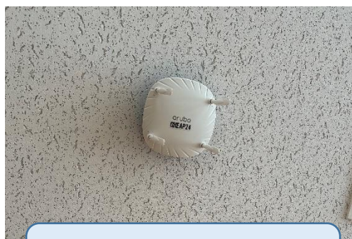
校長室内天井のwifi設備です
